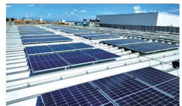
熊谷工場に導入された太陽光パネル
