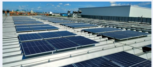
แผงผลิตไฟฟ้าพลังงานแสงอาทิตย์ติดตั้งที่โรงงานคумаเกา
