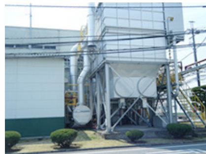
更新された熊谷工場の熱媒ボイラー
