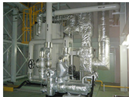
更新された土居加工工場の熱媒ボイラー
