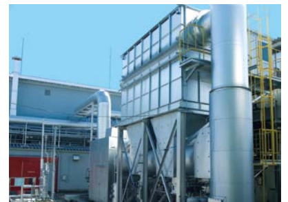
排ガス処理設備
