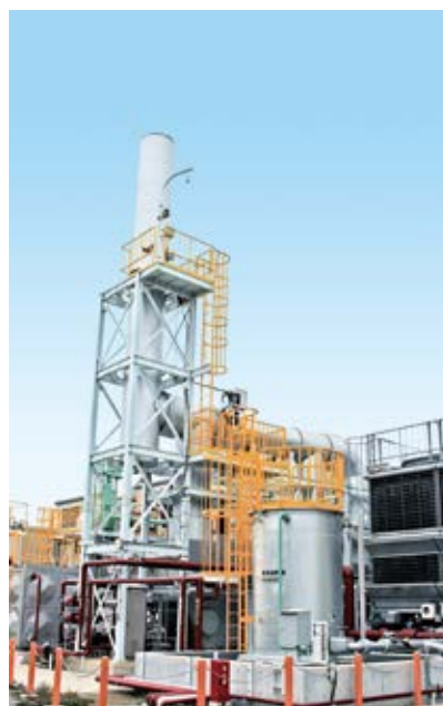
コージェネレーションシステム
