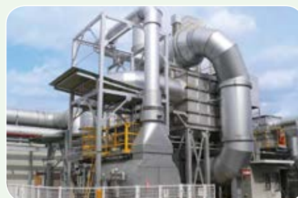
排熱ボイラー
