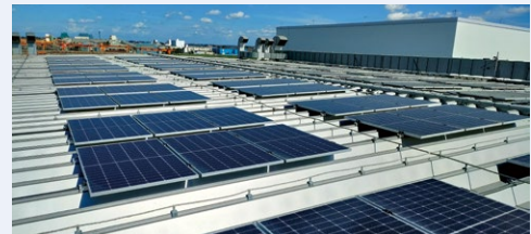
Panel solar dipasang di Kilang Kumagaya
