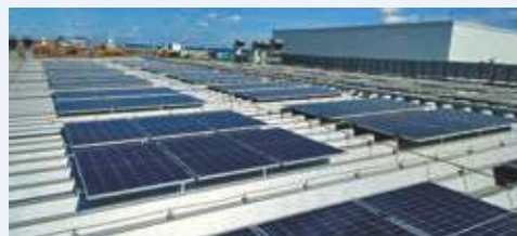
熊谷工場に導入された太陽光パネル
