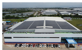
導入された太陽光発電パネル
