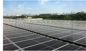
太陽光パネル
