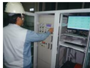
VOC自動監視測定装置
