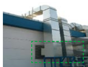
再利用排ガスの排・吸気口
