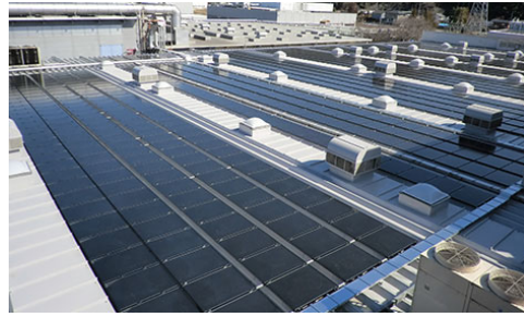
吾妻工場に設置された太陽光パネル (約5,000m 2 )
