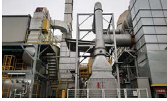
RTO（蓄熱燃焼式排ガス処理設備）
