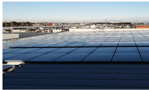
伊奈テクノロジーセンター太陽光パネル
