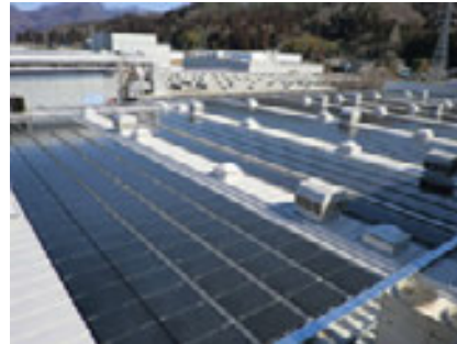
吾妻工場に設置された太陽光パネル (約5,000m 2 )
