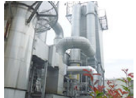
龍野工場の焼却炉ボイラーに設置した空気予熱器
