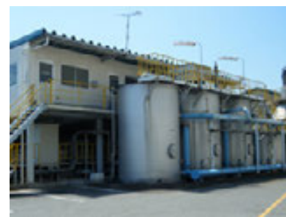
三島工場の排水処理設備
