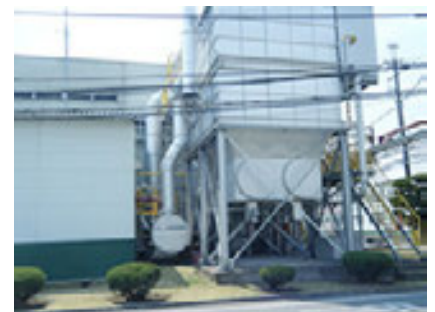
熊谷工場のVOC排熱回収ボイラー
