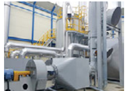
新設した排ガス処理施設（RTO式）
