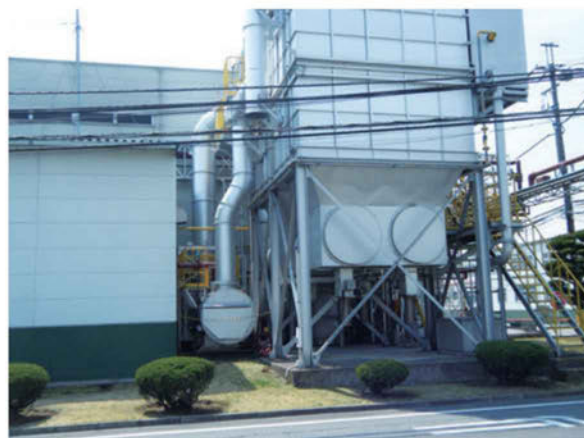
熊谷工場のVOC排熱回収ボイラー
