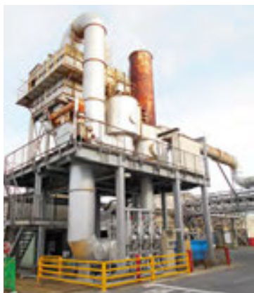
千葉工場の排熱ボイラー
