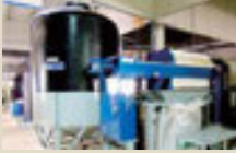
廢水處理設備
