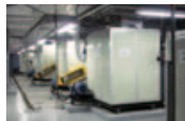
安裝高效率變頻器的空調設備
