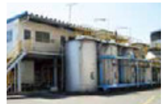
三島工場の排水処理設備
