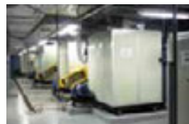
高効率インバーターを設置した空調機
