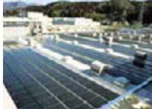
吾妻工場に設置された太陽光パネル (約5,000㎡)
