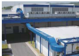
Saluran ekzos udara penyaman udara
