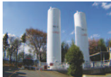
LNG satellite facility
