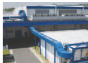
空調的排氣管
