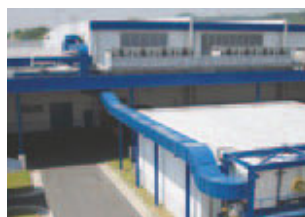
空调气体排气导管
