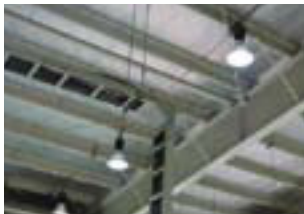
LED照明化した場内
