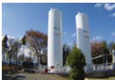
LNGサテライト設備
