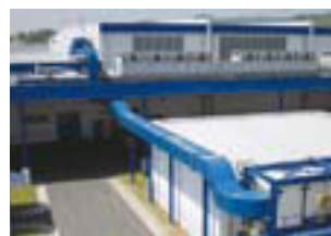
空調エアの排気ダクト
