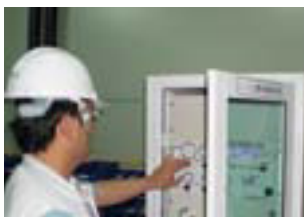
VOC自動監視測定装置
