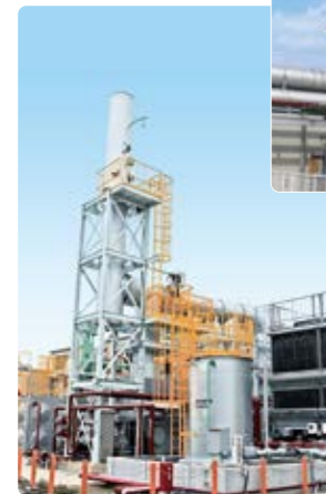
コージェネレーションシステム
