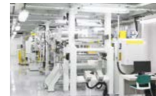
先端技術棟に導入された大型テスト塗工設備
