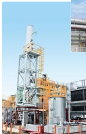
コージェネレーションシステム
