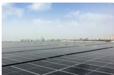
太陽光発電システム
