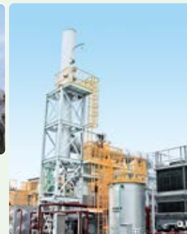
コージェネレーションシステム
