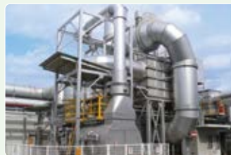
排熱ボイラー
