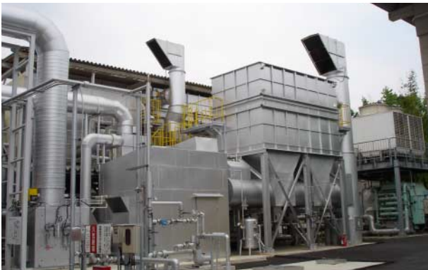
有機溶剤排出ガス処理装置
