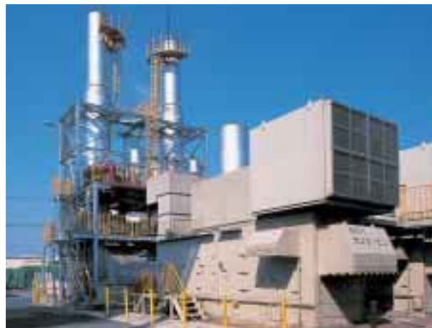
コージェネレーションシステム
